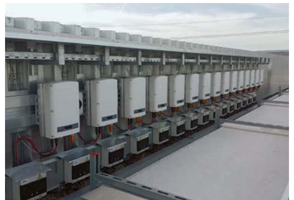
15 Wechselrichter à 17 KVA inkl. Überspannungsschutz
